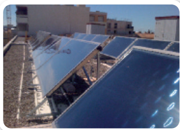
Capteurs installés en toiture terrasse
