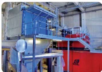
Chaufferie biomasse du site de production de CANDIA à Awoingt (59)
