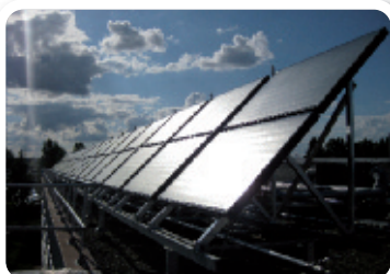
Une partie des capteurs installés en toiture-terrasse
