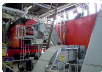
La centrale thermique rénovée
