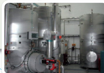
La chaudière à hydro accumulateur et les ballons de stockage solaire
