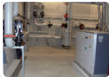
Pompe à chaleur sur champ de sondes dans une maison d'accueil à Saint Florent des Bois (85)
